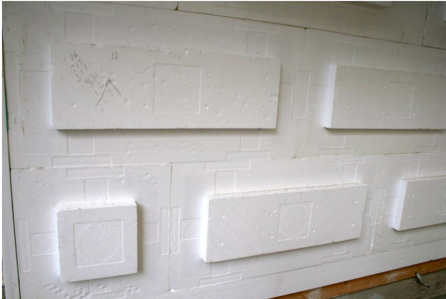
Abbildung 49: Erste Lage des Systems. Die Befestigung der ersten Lage erfolgt in den Plattenstößen mittels üblicher Dämmstoffdübel. Die Befestigungen werden durch eine zweite VIP-gedämmte Lage, den sog. LockPlates, überdämmt.
