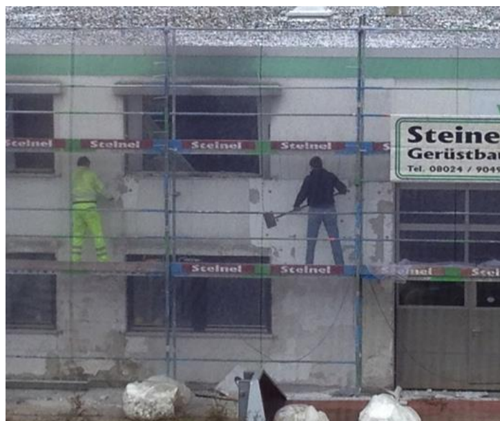
Abbildung 64: Entfernen der EPS-Platten mit einem Eisschaber. Die Dübelschäfte werden mit einem Bohrhämmer mit Meißel gelockert und von Hand herausgezogen (Quelle: FIW München)
